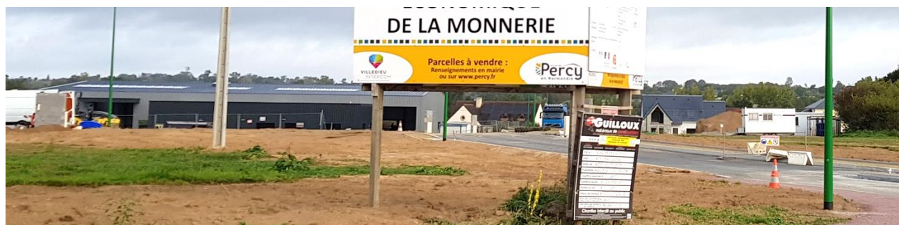
Vue sur l'entreprise en cours de construction, respectant les prescriptions du CRAPE en matière de teinte, de choix des matériaux et de répartition des volumes.
