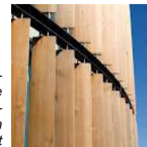
Brise soleil vertical : lutte contre les rayons solaires d'été sur la façade Ouest
